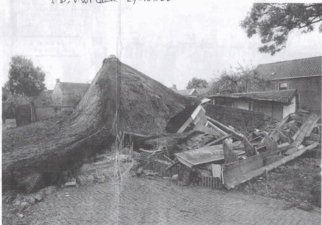
De ingestorte stolpboerderij langs de Dorpsstraat in Zwaag.
