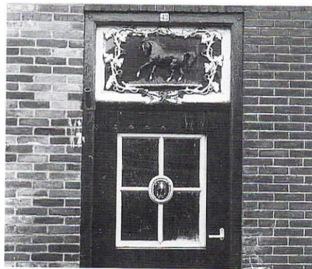
Rechts het mooie, oorspronkelijke voegwerk. Links is het voegwerk redelijk maar vertonen de stenen nogal wat kleurverschil en zijn niet goed schoongemaakt.
