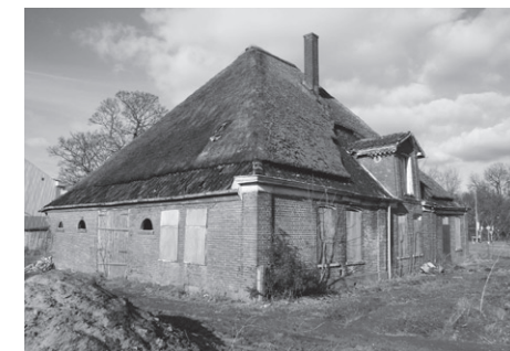
De verloederde stolp in februari 2009.
