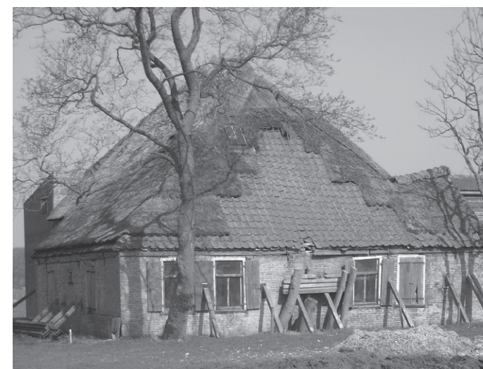
De stolp in sterk vervallen staat.
