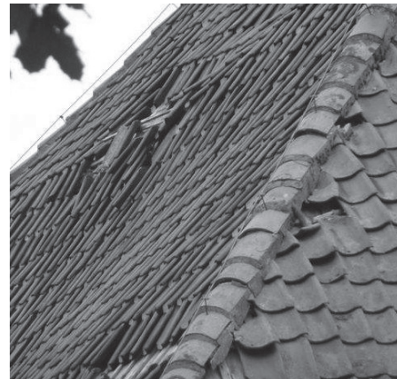
Dringend herstel met de regeling Alle hens aan dak.
