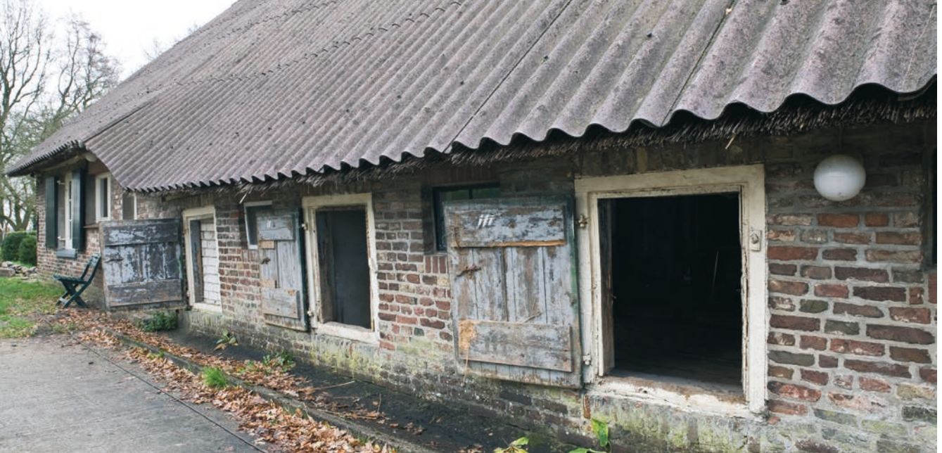
Asbestplaten op het dak leveren gevaar op bij brand
