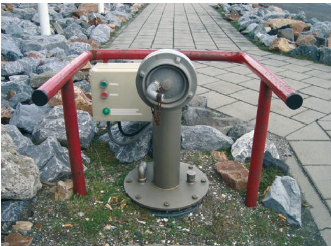
Een brandweeraansluiting voor het oppompen van water
